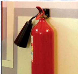
Фотолюминесцентная подложка под огнетушитель
